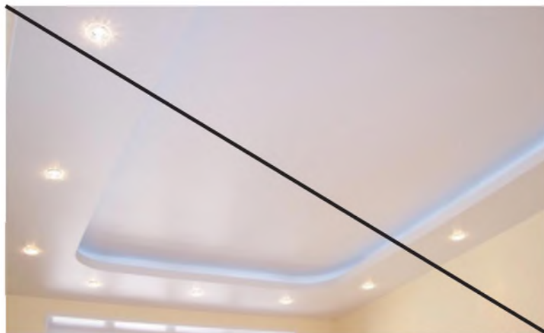
Плохо Многоуровневые гипсокартонные конструкции
